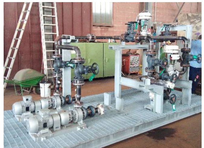
Skid pompe alimento con valvole regolatrici e pompe ridondanti
