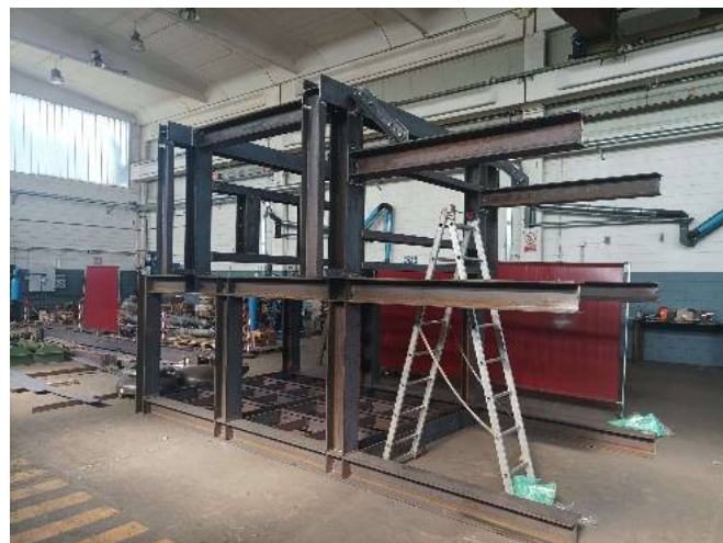
Struttura sostegno generatore di vapore
