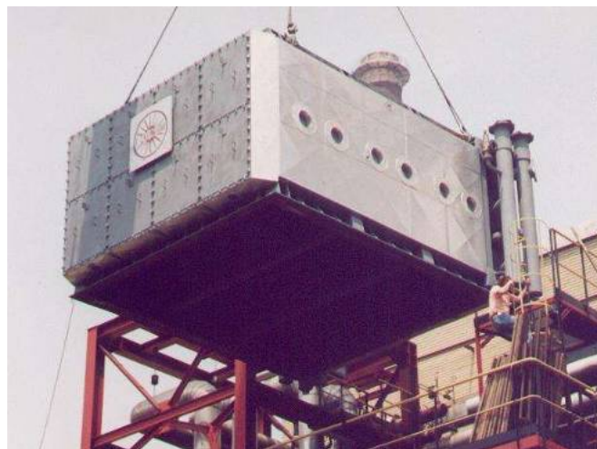
Economizzatore impianto di cogenerazione FIAT Torino
