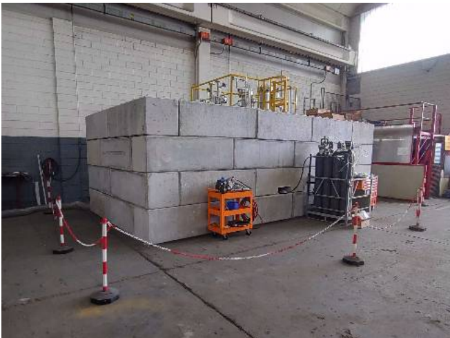
Barriera componibile in cemento per proteggere il personale durante i leak test ad alta pressione
